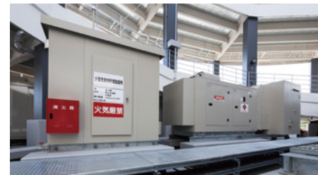
非常用発電機
