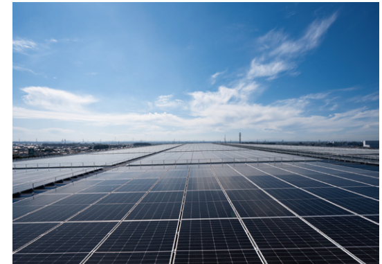
太陽光パネル
